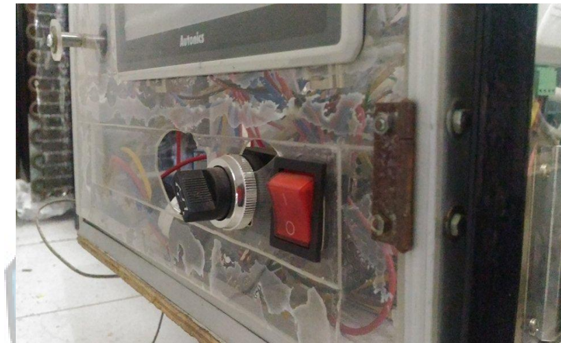
Gambar 3.2 Saklar Pompa, dan Saklar Kipas
