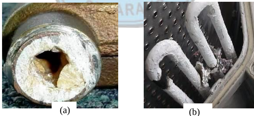
Gambar 2.1. Endapan kerak kalsium Sulfat (a) dalam Pipa (b) permukaan Heat exchangers (Crabtree dkk, 1990).
