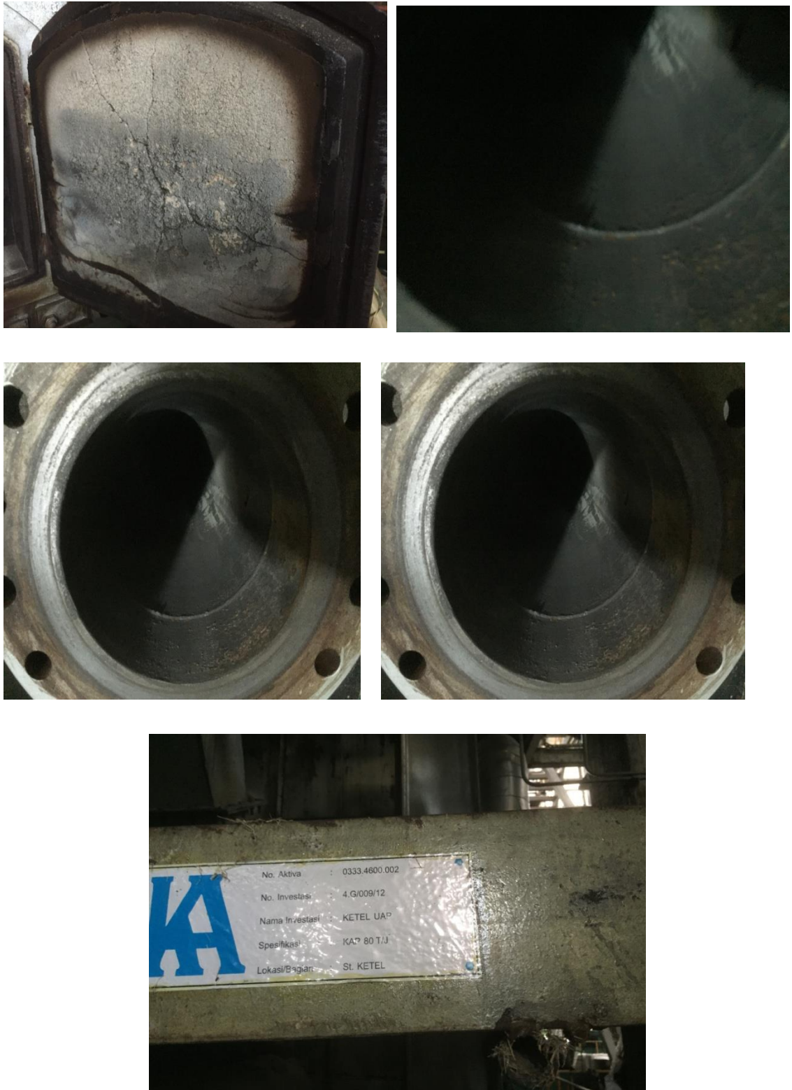
Gambar 10.1. Sampling kerak pada Boiler dan Pipa
